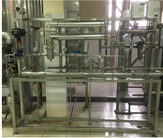
UV-Systeme zur Luftdesinfektion in einer Brauerei (Projekt mit Alpha Corp.) Vietnam
