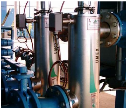
Abwasserdesinfektion in der Chemieindustrie UV-Anlage mit Mitteldruckstrahler UXPM AW 23 D – Volumenstrom: 25 m 3 /h Brasilien
