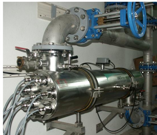
Abwasserdesinfektion in einer Kläranlage UV-Anlage mit Niederdruckstrahlern UXP P 139 – Volumenstrom: 50 m 3 /h Deutschland
