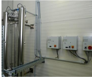
UV-Anlage zur Prozesswasserdesinfektion 2x VAP-P 360 für 76m 3 /h Deutschland
