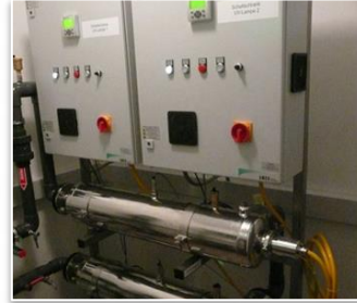
2 x UXPM OX 7000 E zur Cyanid- Entfernung im Grundwasser, Deutschland
