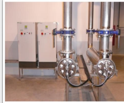
UV-Anlagen zur Prozesswasserdesinfektion 2 x UXP P 3200 (2 x 168 m 3 /h) Deutschland
